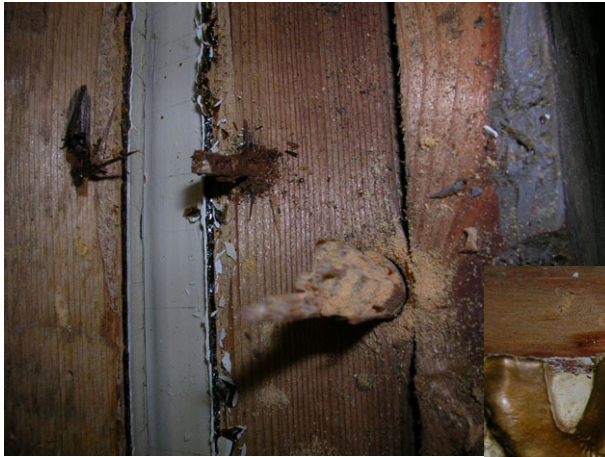
ØV- borebiller og ødelagt træ!
